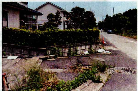
仮設の水道管が町中に見られた
