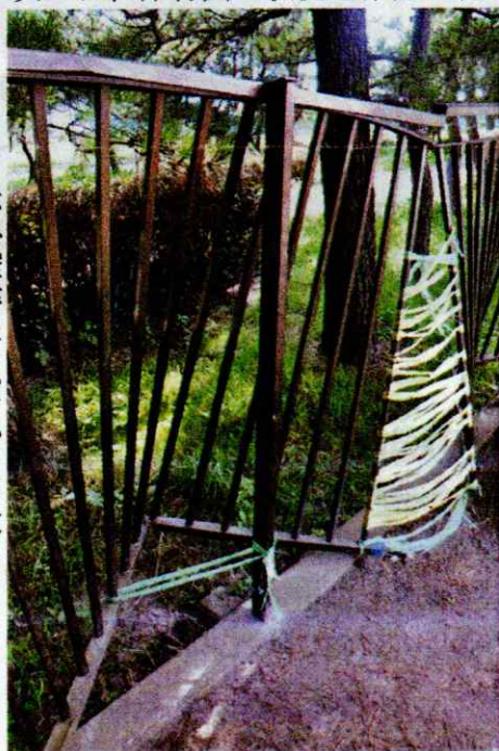
応急処置で止まっているフェンス
